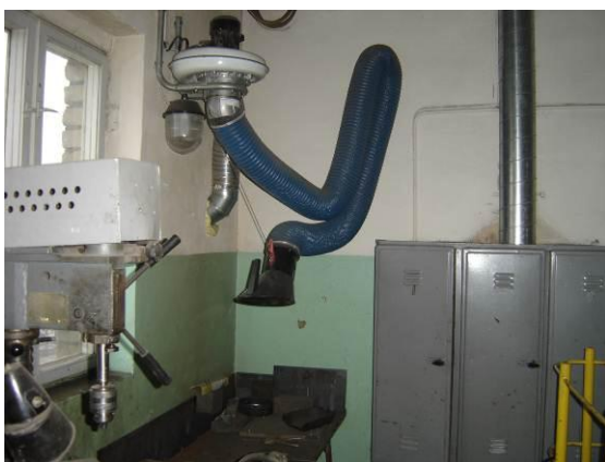
Lokālās nosūces ventilācijas piemērs – iespējams regulēt nosūces novietojumu tā, lai kaitīgās vielas netiktu nosūktas caur nodarbinātā elpošanas zonu.
